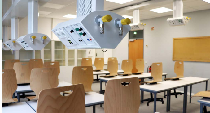
Das höhenverstellbare Deckensystem versorgt die Arbeitsplätze mit Strom und Gas und ermöglicht flexibles Experimentieren.
