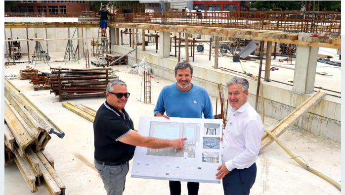
Gemeinsame Besichtigung der Baustelle (v.l.): Franz-Josef Kaimann, Geschäftsführer der Sennebad GmbH, André Wiersig, Extremschwimmer und Schirmherr des Hallenbads sowie Bürgermeister Michael Berens.
